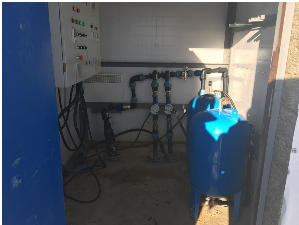
Фото 13. Помещение, в котором находятся скважины ООО «ОМХ».
