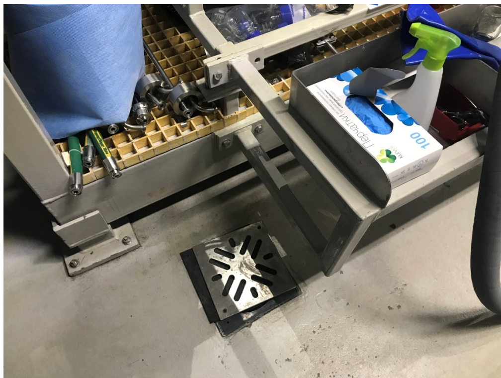
Фото 9. Система сбора сточной воды из производственного цеха
