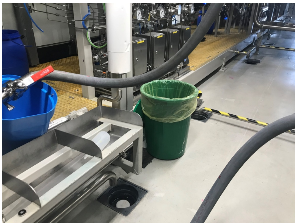
Фото10. Система сбора сточной воды из производственного цеха
