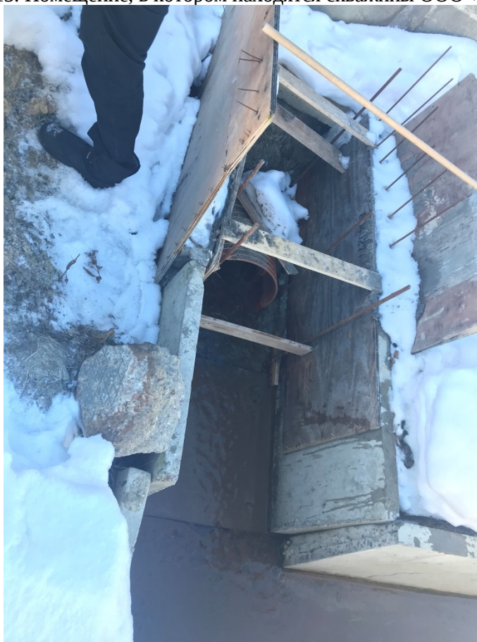
Фото 14. Выпуск сточных вод в железобетонный лоток после локальных очистных сооружений ООО «ОМХ»
