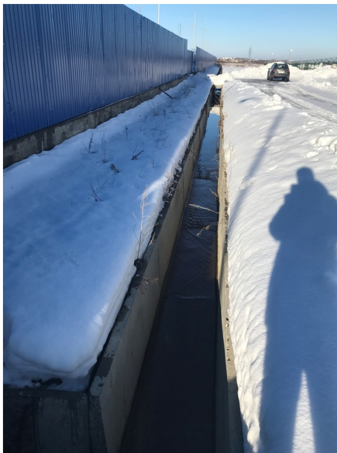
Фото 15. Железобетонный лоток, куда осуществляется выпуск сточных вод после локальных очистных сооружений ООО «ОМХ»
